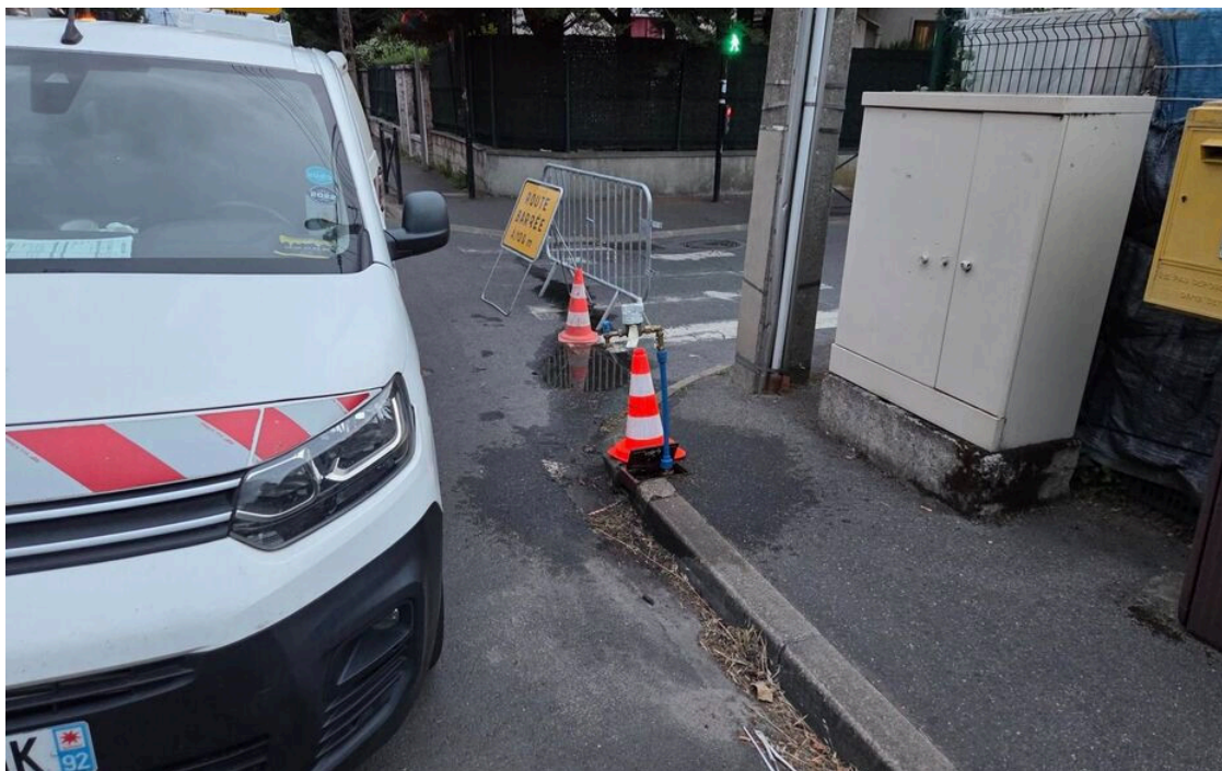
Groslay, mercredi 6 août. Le secteur de la rue de Montmagny est au centre d'une série de ruptures de canalisation. Le 19 juillet dernier déjà, tout un secteur avait été privé d'eau le temps des réparations. Mairie de Groslay
